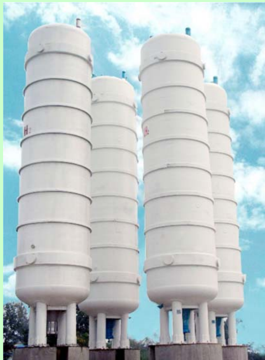
80m 3 液氢贮槽群
